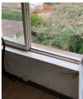
Absence de garde-corps
