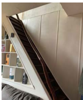
Absence de rambarde de sécurité sur l'escalier
