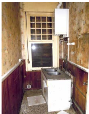
Non décent (avant travaux)
